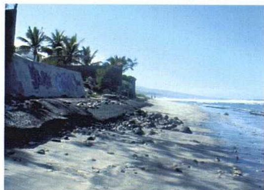
Affouillement des ouvrages de défense (La Souris Chaude)
