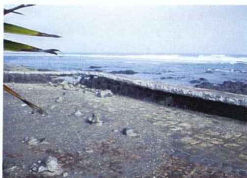
Destruction d'une terrasse construite sur le lagon (Grand Bois)
