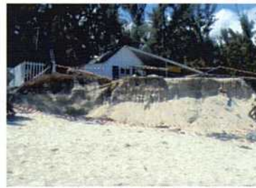
Effondrement d'une terrasse de restaurant
