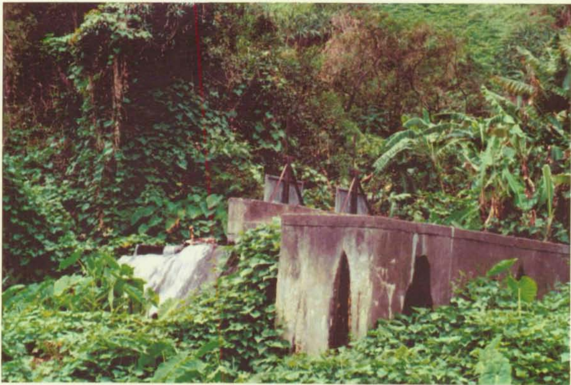
Le captage E. Avril
